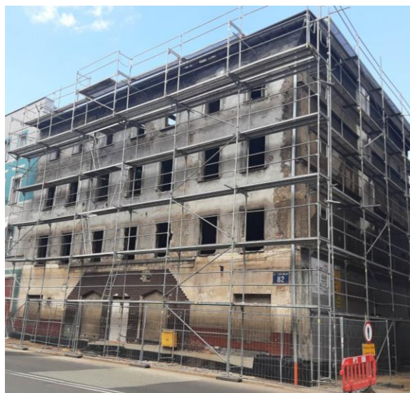
Fot. Budynek przy ul. 1-go maja 82 w Wałbrzychu – podobszar Sobięcin, pierwszym etap inwestycji
